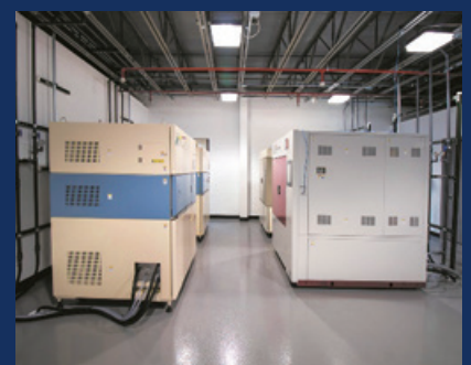
テストラボ装置設置状況
